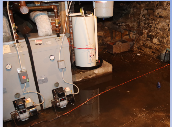
Dégât d'eau survenu le 9 novembre 2023 dans le sous-sol de la Gare.
