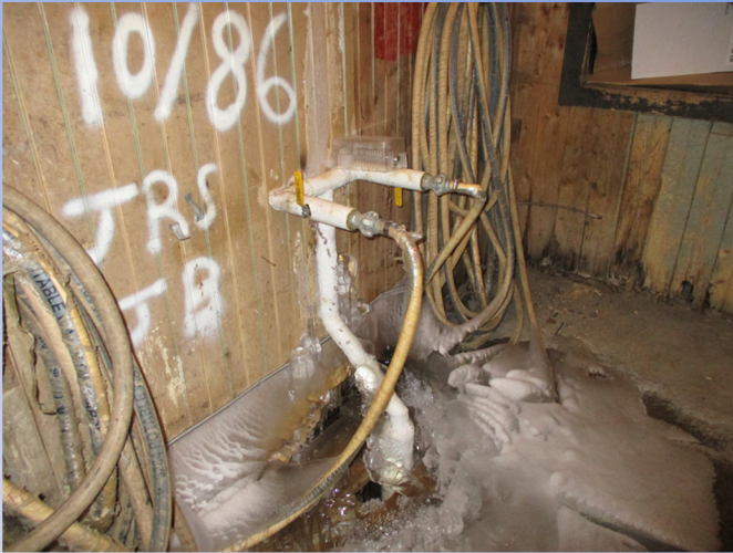
Valves à eau qui ont éclatées le 1er février 2024 dans le local de la SCFG.
