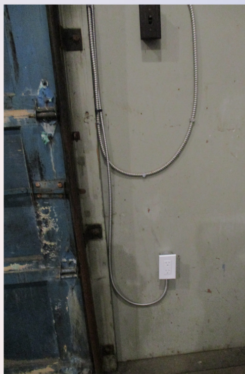
Une prise de courant a été ajoutée à côté de la grande porte de garage pour répondre au besoin en énergie dans ce local.
