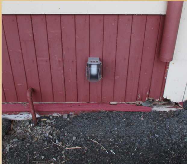
Ajout d'une prise de courant sur le mur côté Est de la Gare pour les besoins du déneigeur.
